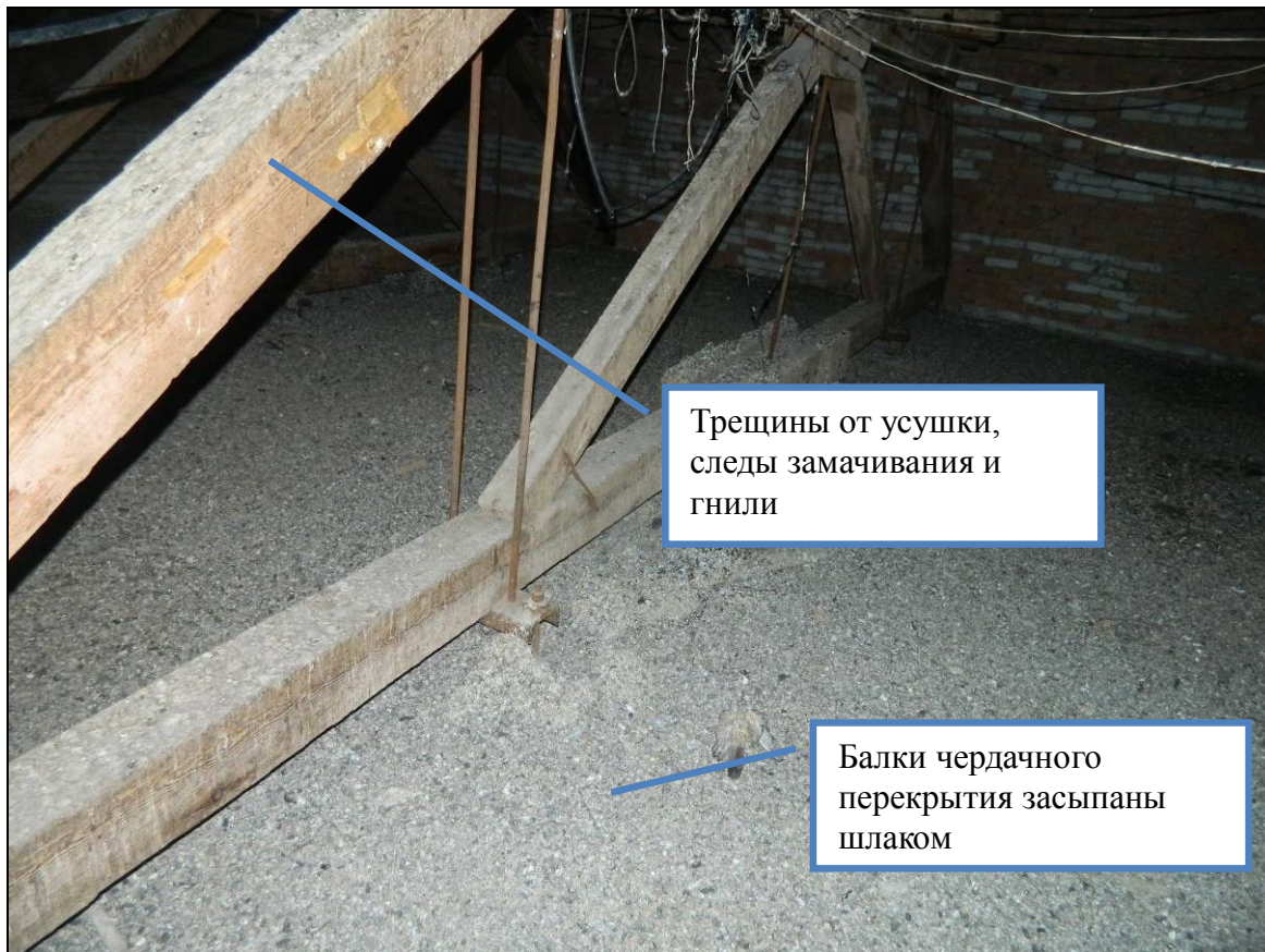
Рис. 21 Нижний пояс деревянной фермы в осях «4-6/И-Н»
